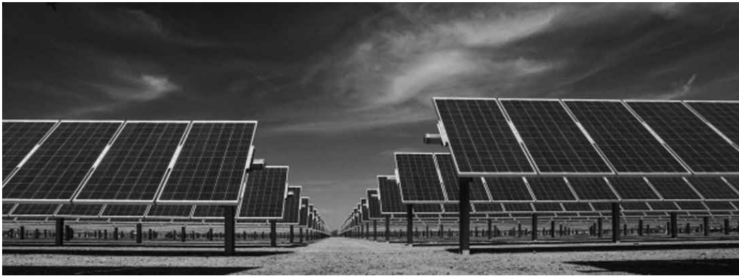
현대중공업그린에너지가 142MW 규모의 모듈을 공급한 미국 애리조나주의 태양광발전소(AVSE II) 전경
